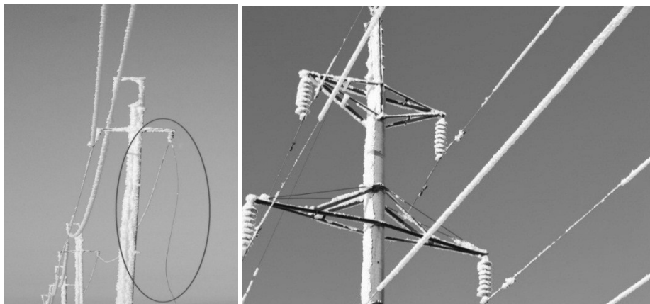
Рисунок 1. Образование наледи, обрыв проводов
